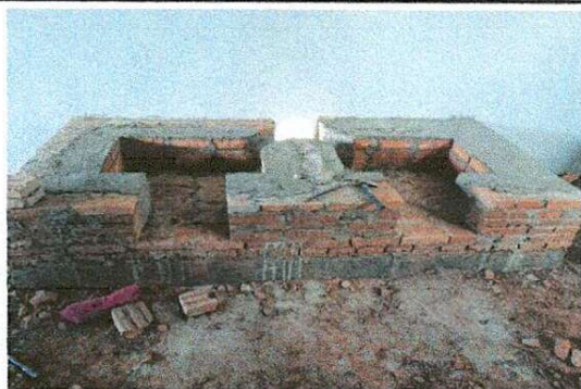
Foto 3: CONDICIÓN DE LA NUEVA PLANCHA RURAL DE LA COCINA
